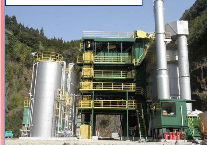
仮設アスファルトプラント全景
