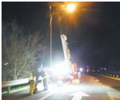
道路灯設置状況
