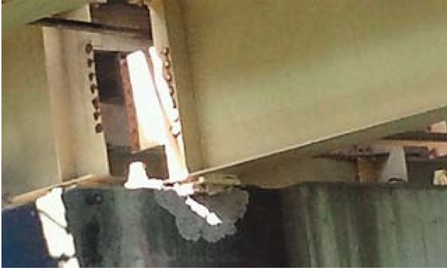
平成28年4月15日10時 被災後の状況
