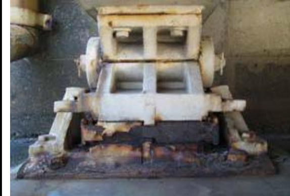
漏水による支承の劣化
