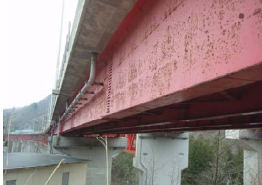
鋼桁の塗装劣化
