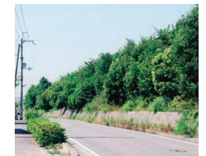
樹林化後のり面
