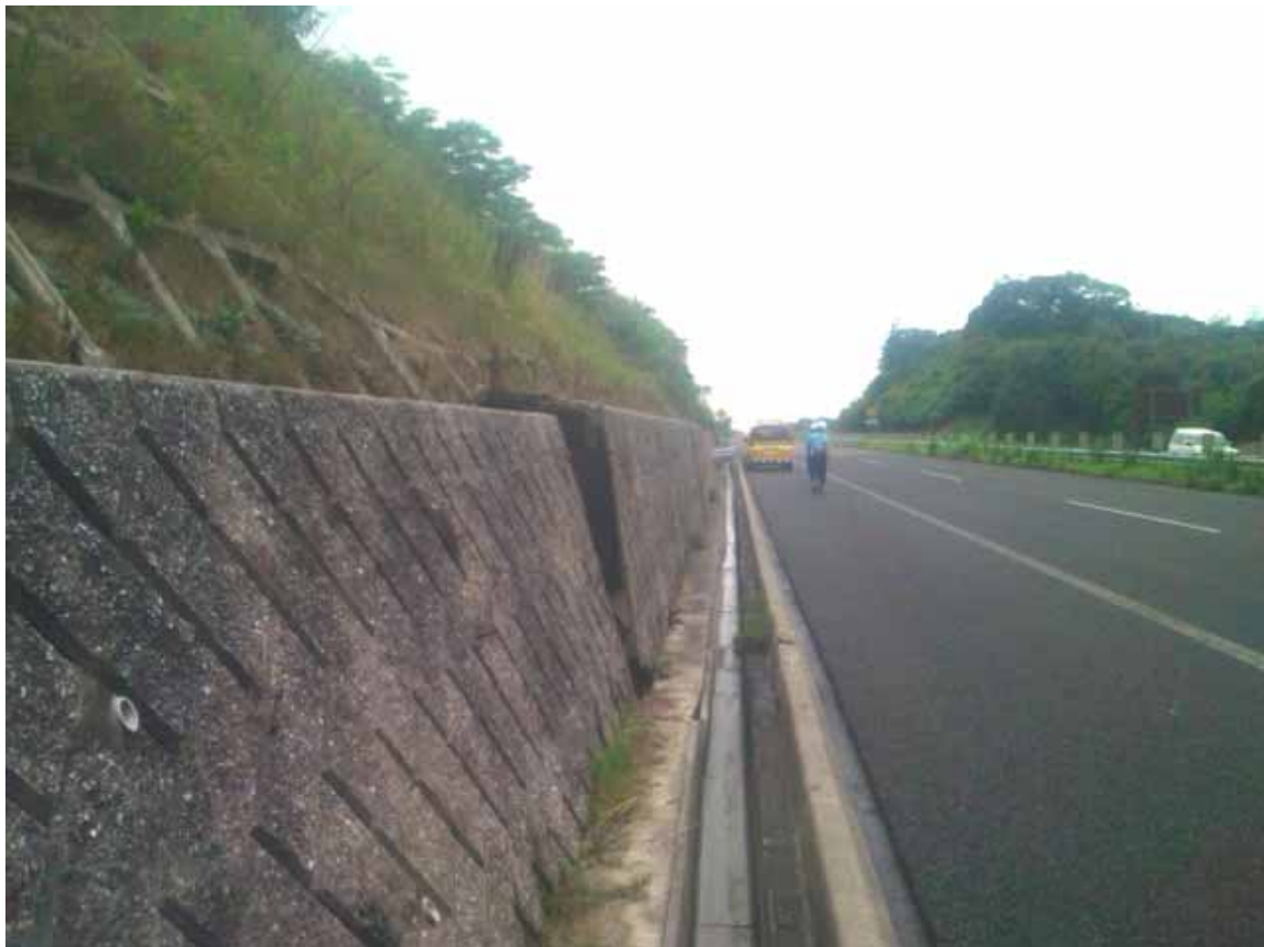
のり面変状の状況写真
