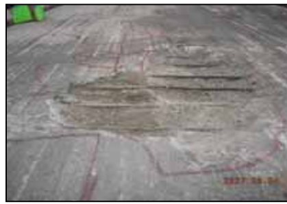
《床版上面損傷》
