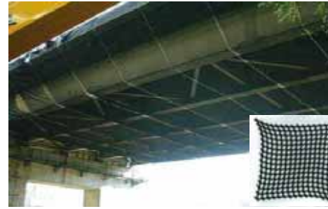
《はく落防止ネット》
