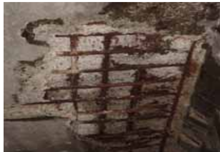
《床版下面損傷》
