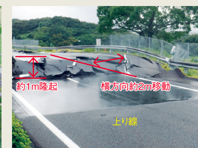
路面の被害状況
