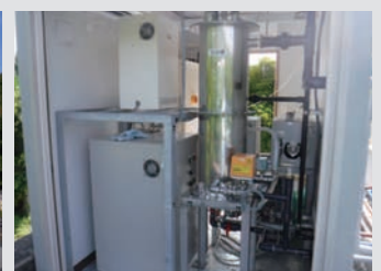
汚泥の減容化装置
