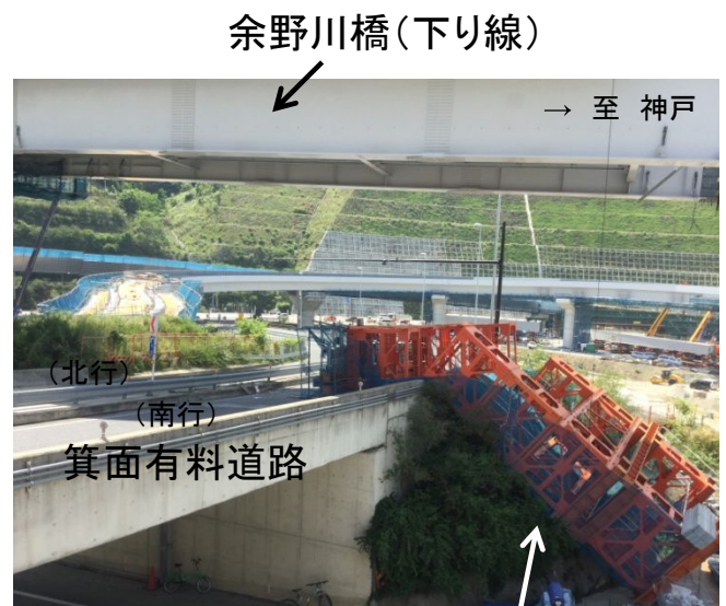
転倒した仮受設備(ベント)
