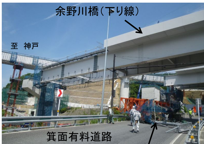
転倒した仮受設備(ベント)
