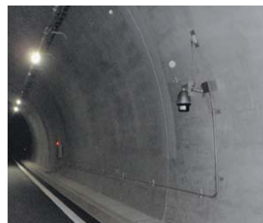
トンネル内カメラ設置状況
