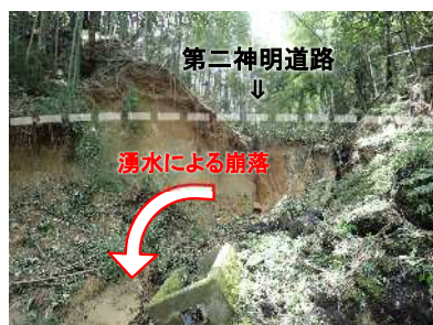
現地状況 （断層部における土砂崩落）
