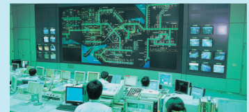
道路管制センター
