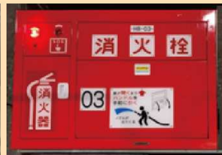
トンネル非常用設備
