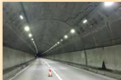
トンネル照明設備
