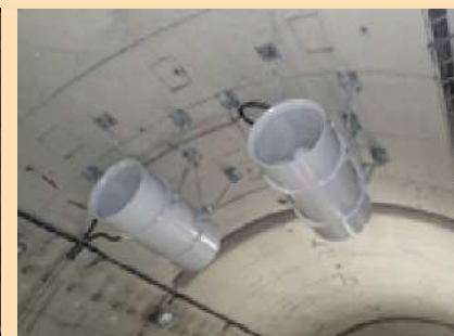
トンネル換気設備
