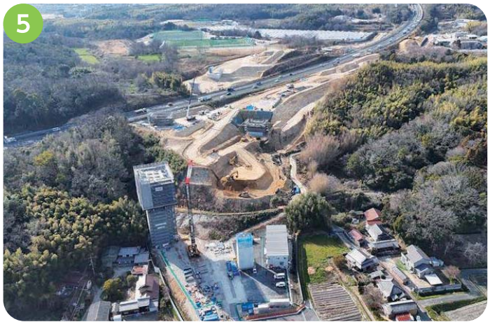
5 石ヶ谷JCT付近 橋台、橋脚を構築する工事、地山を道路の高さまで掘削する工事を行っています。また明石川を渡河する橋梁工事を行っています。
