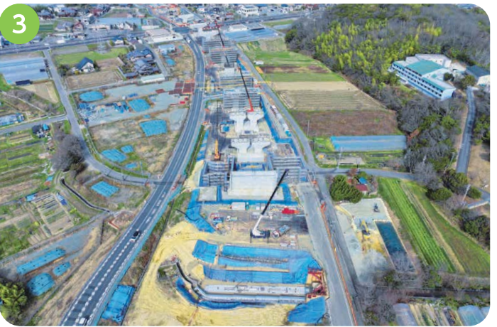
3 下村地区 地山を道路の高さまで掘削する工事、橋台、橋脚を構築する工事を行っています。
