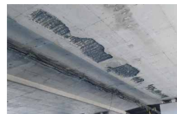
損傷が進行した床版
