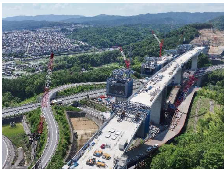
② 橋梁上部工の張出架設及び橋梁下部工の施工を行っております。
