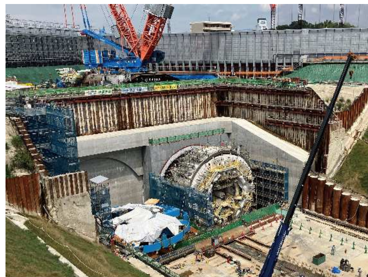
⑦ トンネル掘削のための準備工の施工を行っております。
