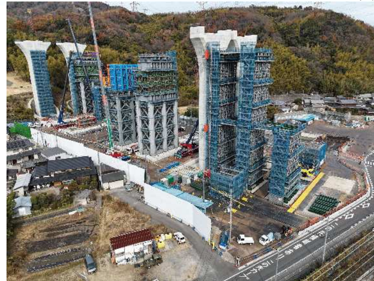
③ 橋梁上部工のための仮設備（ベント）の施工を行っております。
