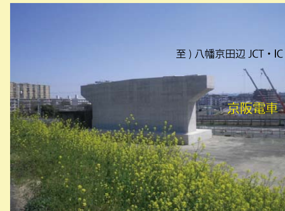
③ 淀川河川内（枚方市域側）で橋脚の施工を行っています。
