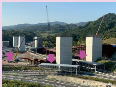
① 上部工施工のための作業構台（矢印部分）を設置しました。
