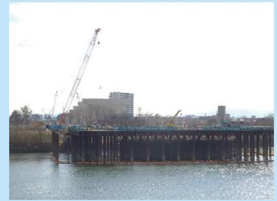
④ 淀川河川内の橋脚箇所で基礎内の地盤改良を実施しております。
