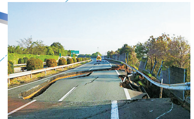
高速道路損傷状況（熊本地震〈左〉、大雪による立ち往生〈右〉）
