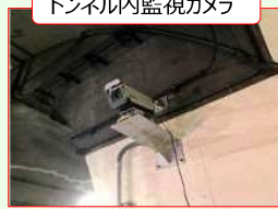
トンネル内監視カメラ
