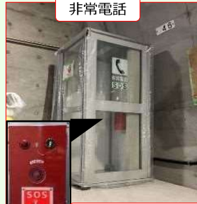
押ボタン通報装置
