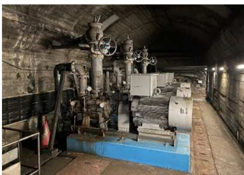
排水設備（水抜ポンプ）
