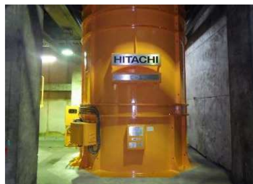
換気設備（排風機）
