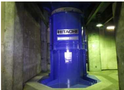
換気設備（送風機）
