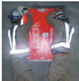
消火器設置状況
