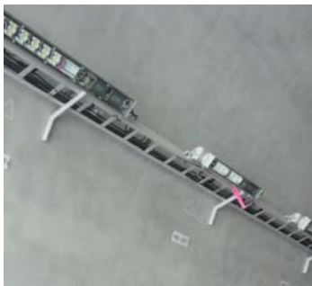
照明灯具設置状況
