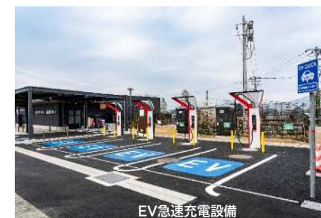
EV急速充電設備
