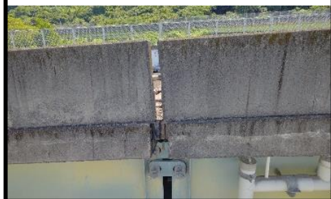
桁間に開きが生じている
