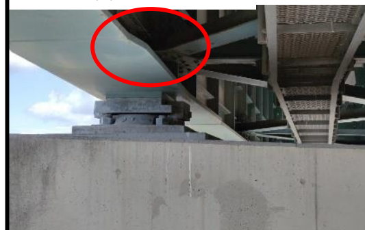
桁に座屈が生じている
