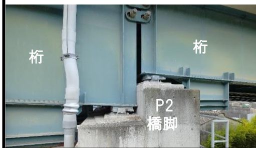
桁と橋脚が衝突している
