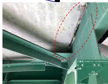
床版コンクリート付着切れ
