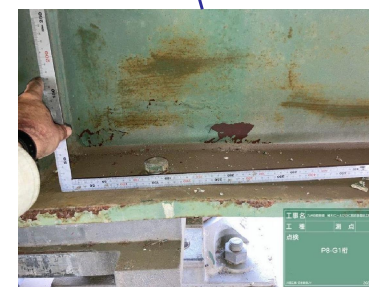
主桁下フランジ座屈 (P8支点上)
