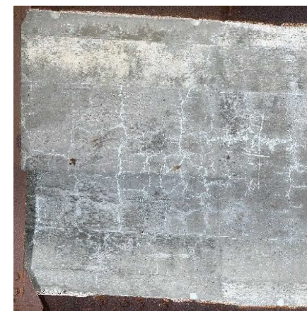
エフロレッセンスを伴うひび割れ
