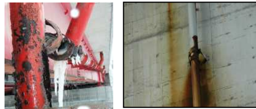
凍害による破損
