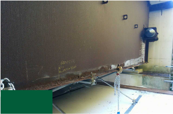
補修前(桁端部の腐食)
