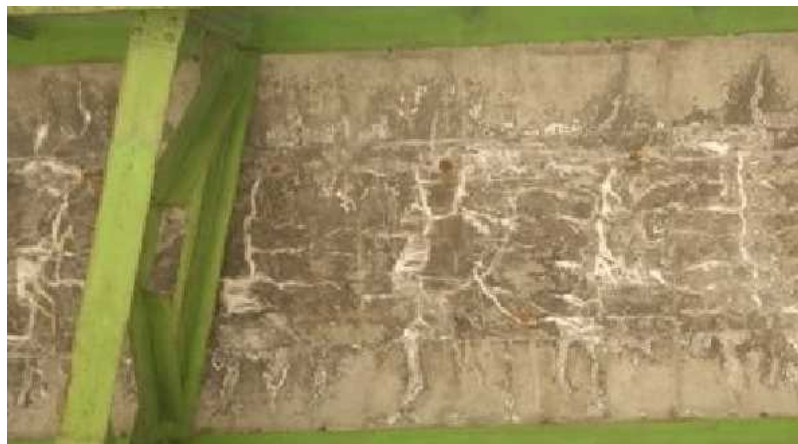
二方向に拡がるエフロレッセンスを伴うひび割れ
