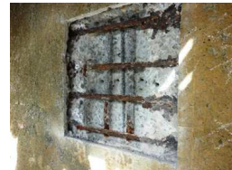
漏水部の鉄筋腐食
