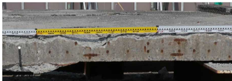
上面において土砂化が発生
