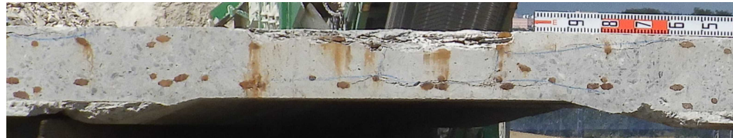
土砂化が著しい箇所では鉄筋腐食、水平ひび割れに加えて、上面から下面に繋がるひび割れが進展(鉄筋位置の塩化物イオン濃度7.06kg/m 3 )
