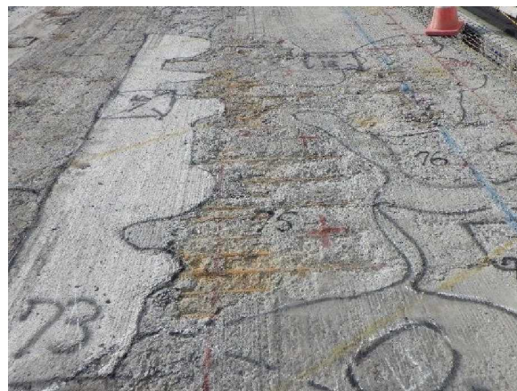
土砂化、鉄筋腐食による断面減少が発生
