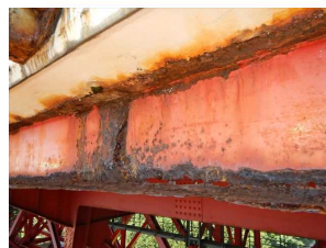
縦桁の変状例
