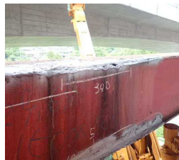
下弦材の変状例
