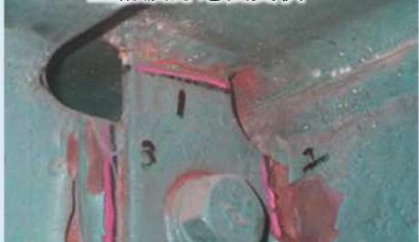
【西】 近畿自動車道 鶴野高架橋 主桁疲労亀裂変状
