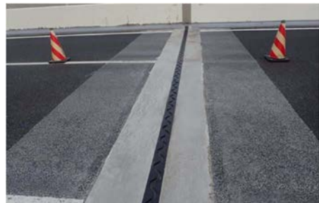
《伸縮装置の損傷(補修後)》
