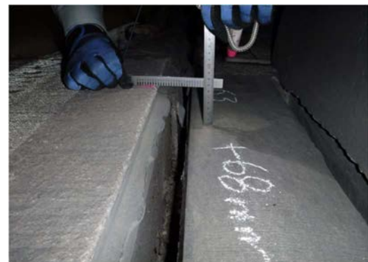
<トンネル路面隆起による段差>
