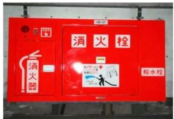
<更新後の消火栓>
