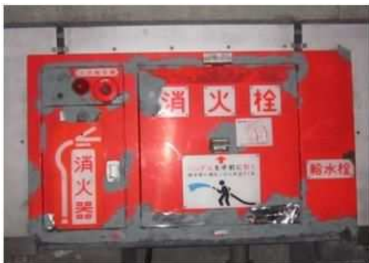
<従前の消火栓>
