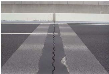
《伸縮装置の損傷(補修前)》
