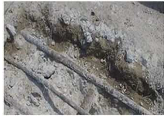
<床版上面のコンクリート土砂化>
