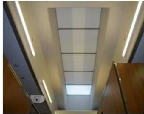
<トイレ照明のLED化>
