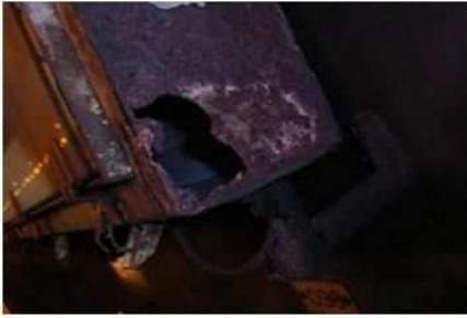
《トンネル照明の緊急補修(補修前)》
