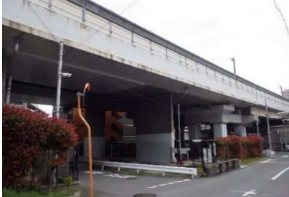
《橋梁上部工はく落対策(補修前)》
