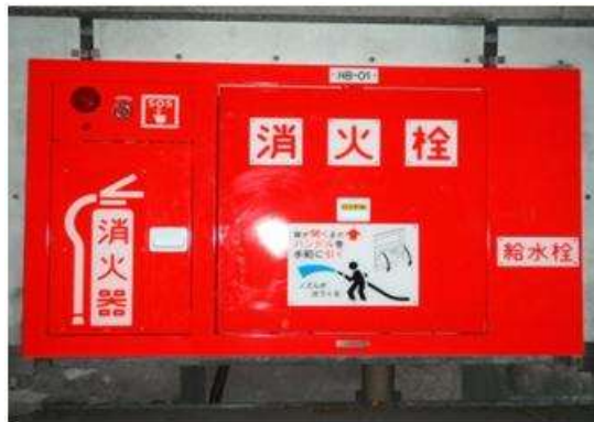
《更新後の消火栓》
