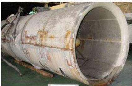
《トンネルジェットファン（補修前）》
