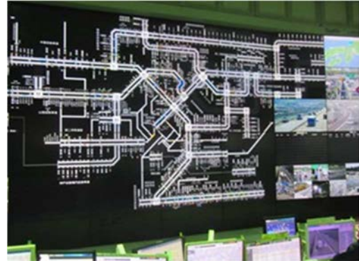
《道路管制センター》
