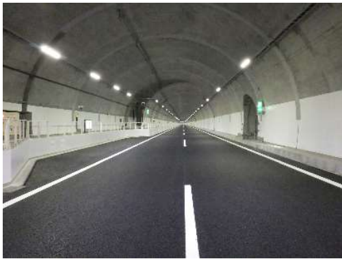
《トンネル照明のLED化》
