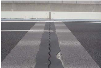
《伸縮装置の損傷（補修前）》
