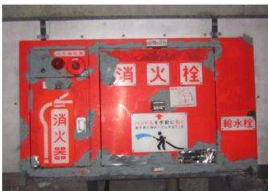
《従前の消火栓》
