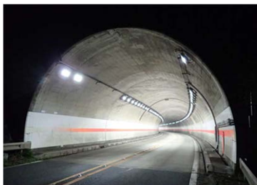
《更新後のLED照明》
