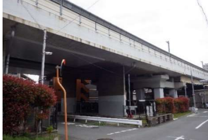
《橋梁上部工はく落対策（補修前）》
