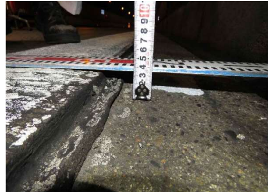
《トンネル路面隆起による段差》
