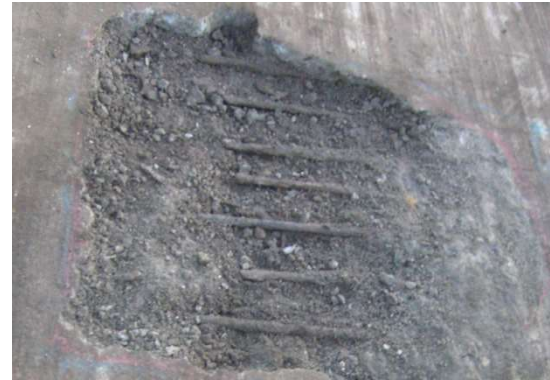
《床版上面のコンクリート土砂化》
