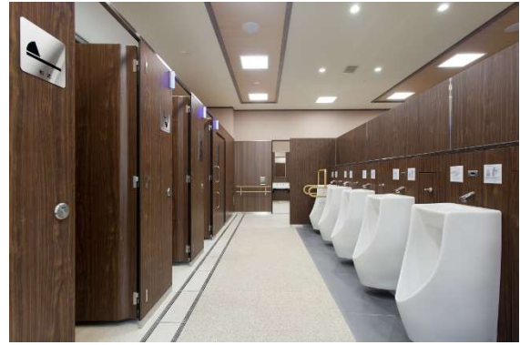
《トイレ照明のLED化》
