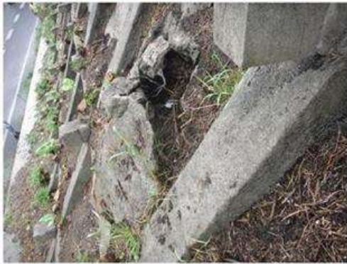
《グラウンドアンカーの機能低下によるのり面変状》
