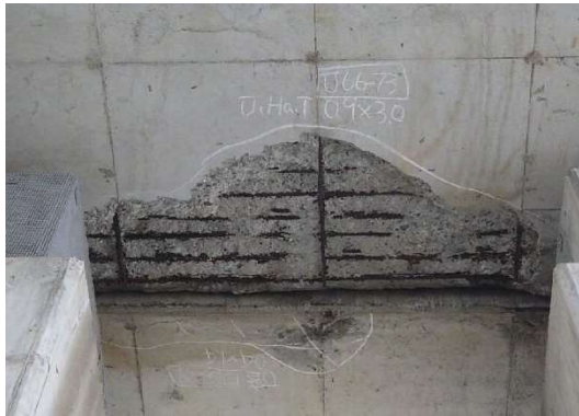
《床版下面のコンクリート剥離・鉄筋腐食》
