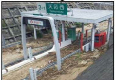
・土砂流入による料金所閉塞
