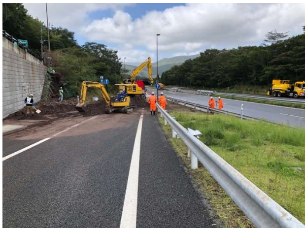
② E3 九州自動車道 (応急復旧後)
