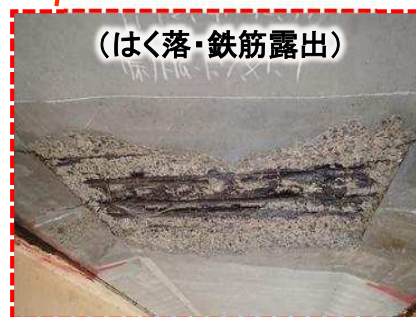
床版下面の損傷状況①
