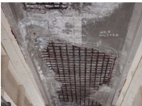
腐食劣化した橋梁
