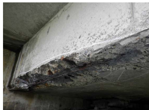
腐食劣化した橋梁
