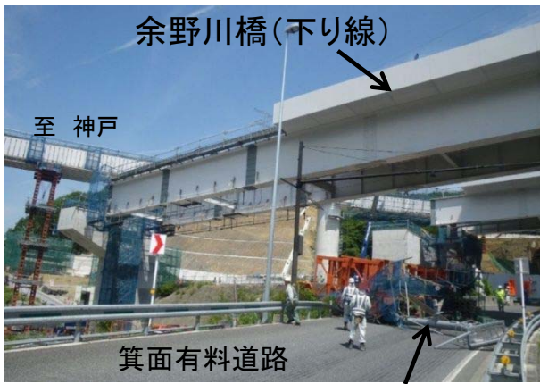
転倒した仮受設備(ベント)
