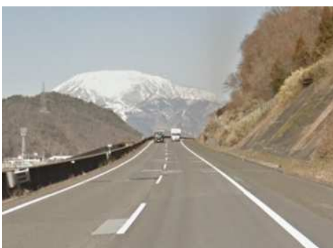
舗装損傷状況
