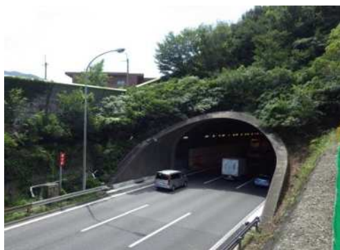
樹木繁茂状況
