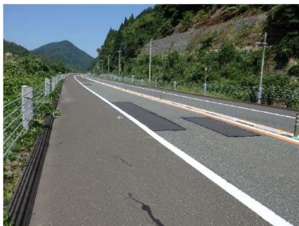
《舗装損傷状況》
