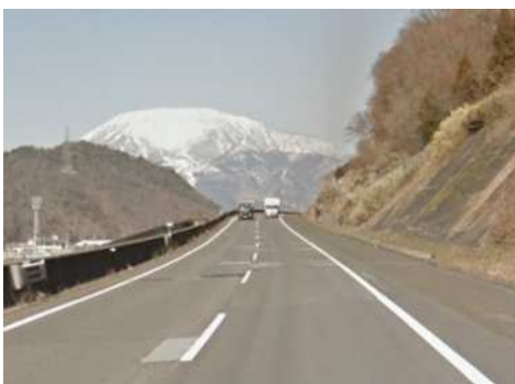
舗装損傷状況
