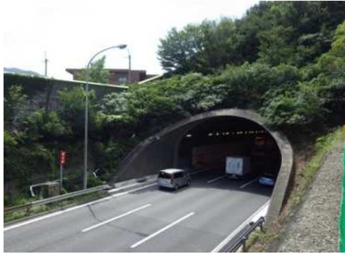
樹木繁茂状況
