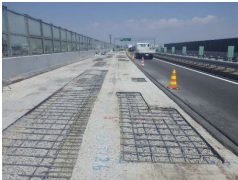
コンクリート床版損傷状況
