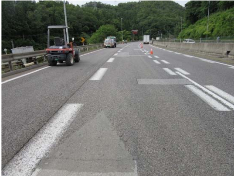
舗装損傷状況
