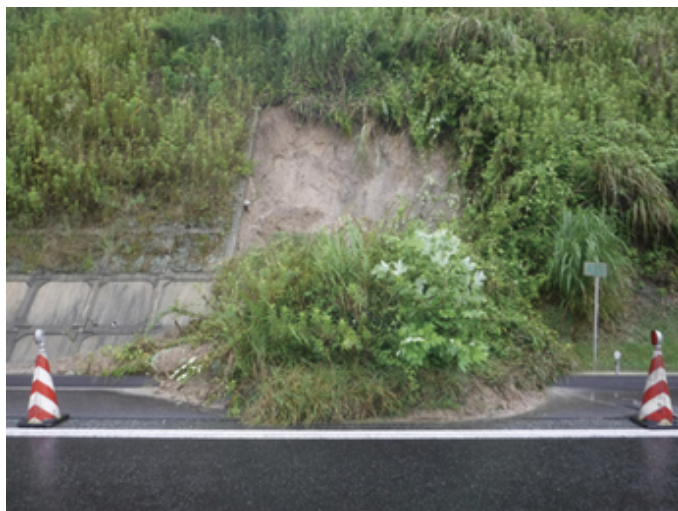
のり面崩壊状況（発災時）
