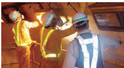
道路や設備等の維持管理
