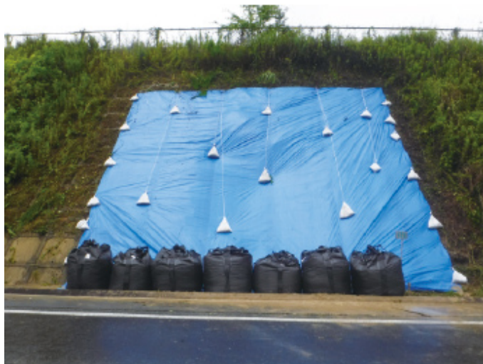
のり面崩壊状況（応急復旧後）
