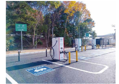
EV急速充電設備(山陽道 三木SA(上))
