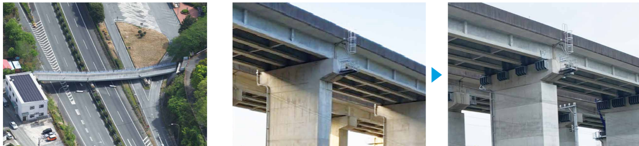
熊本地震で九州道を横架する県道が落橋
