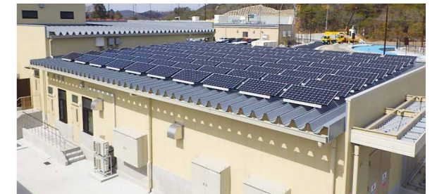
SA・PA建物屋上での太陽光発電
