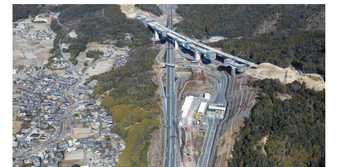
高槻JCT・IC～八幡京田辺JCT・ICの建設が進む新名神高速道路 高槻JCT・IC付近
