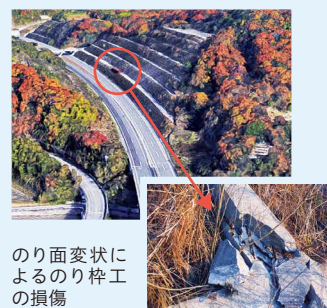
地すべり対策をしても変状が収まらない切土のり面(山陽道 木津地区)
