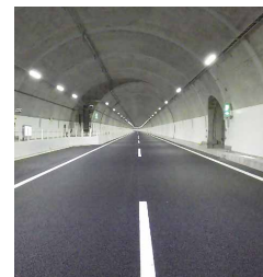
トンネルLED灯
