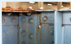
鋼材の疲労亀裂
