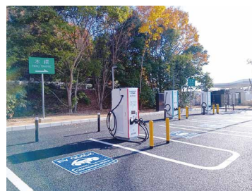
EV急速充電設備 (山陽道 三木SA(上))
