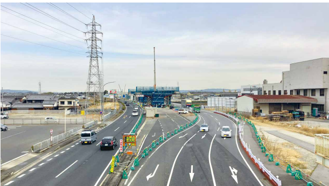
国道24号線交通規制状況
