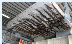
床版下面の剥落
