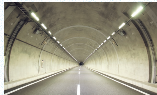
トンネルLED灯
