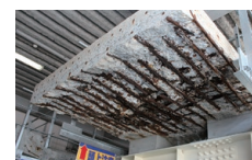
床版下面の剥落
