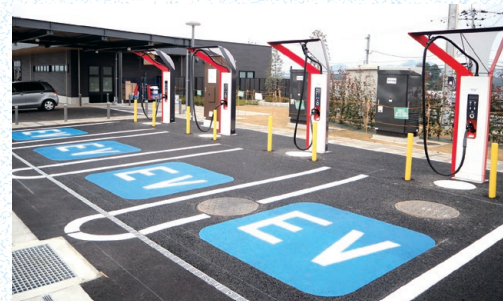
急速充電設備
