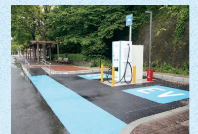
EV急速充電設備(高松道 豊浜SA(下))
