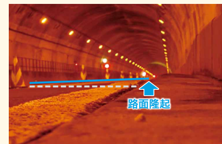
工事前（路面隆起により段差が発生）
