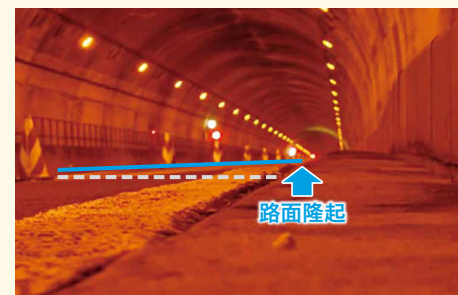
工事前（路面隆起により段差が発生）
