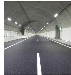
トンネルLED灯
