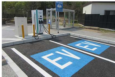
SA・PAにおけるEV急速充電システム
