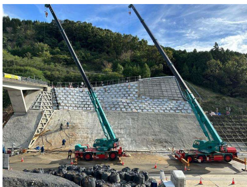
東九州自動車道 臼杵IC～津久見IC (高速道路区域外からの土砂流入 / 高速道路の災害対応)
