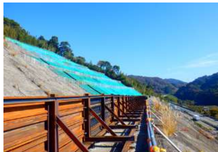
昼夜連続走行車線規制から路肩規制へ切り替え。今後、落石防護柵内で本復旧工事を実施予定。
