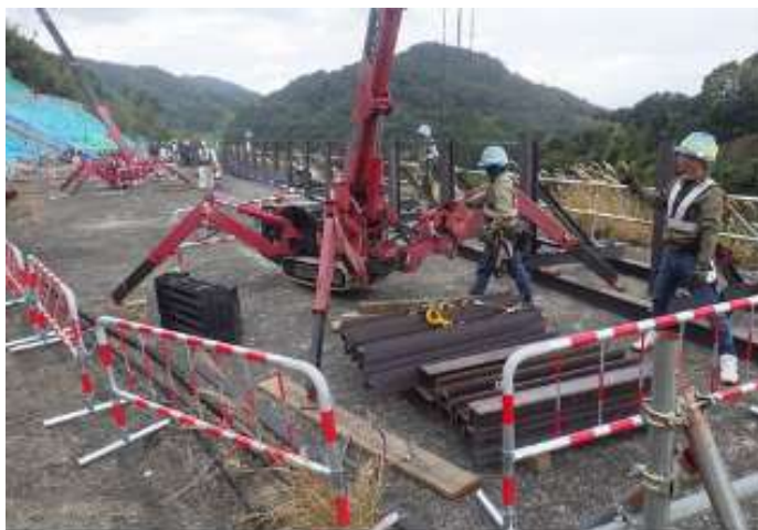
のり面変状箇所の本復旧工事のため仮設落石防護柵を設置。
